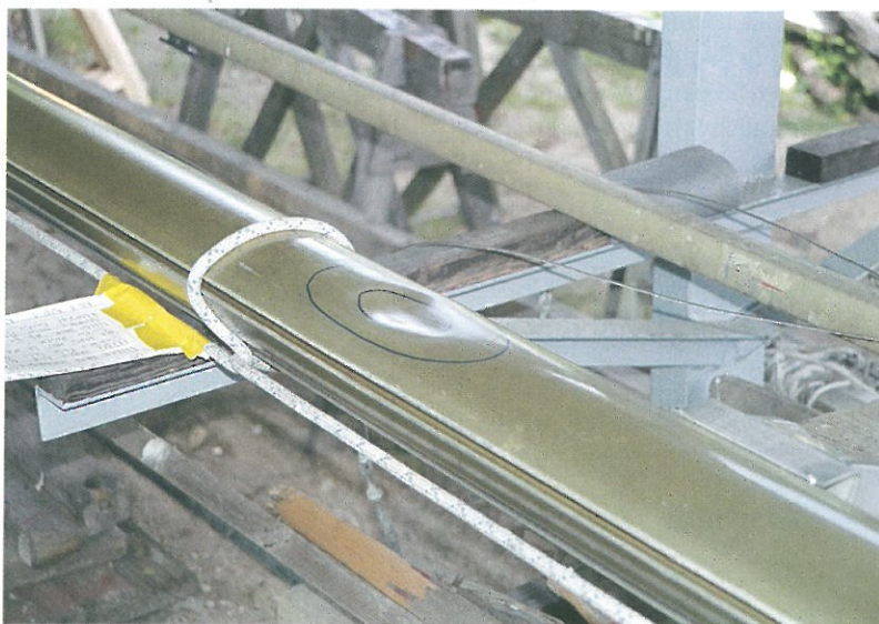
Derartig beschädigte Mastprofile müssen sofort ausgewechselt werden. Werden sie weiter benutzt, ist ein Mastbruch vorprogrammiert.
